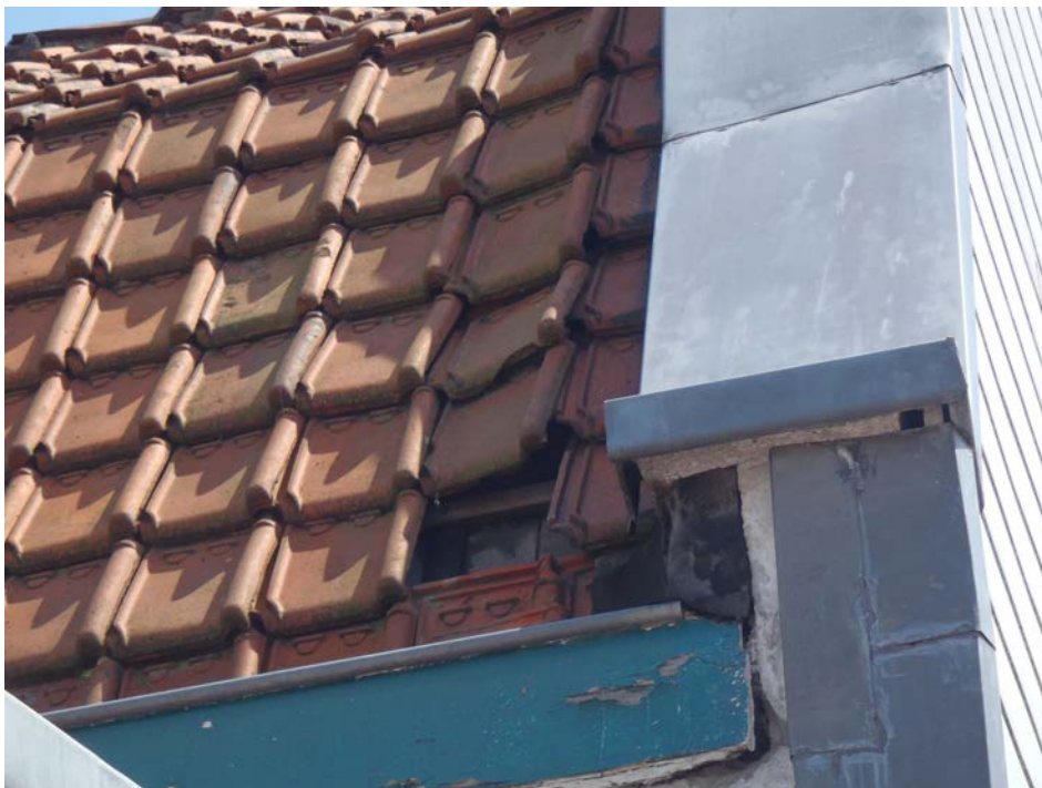
Ontbrekende en scheefliggende dakpannen, gaten en los zittende, houten betimmering maken het woonhuis potentieel geschikt als verblijfplaats voor vleermuizen of als broedplaats voor gierzwaluwen en huismussen.
